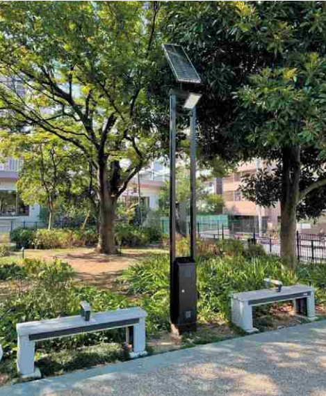
ソーラー照明・かまどベンチの設置 (豊海運動公園／中央区)
