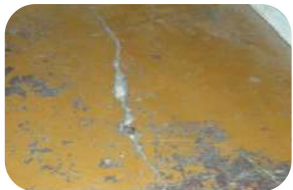
床のひび割れ
