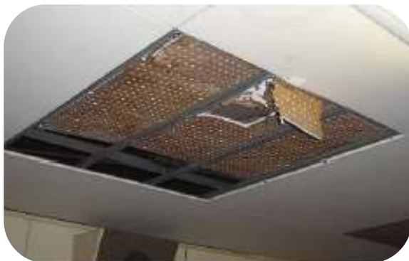
天井材の落下・剥がれ
