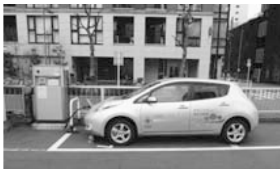
電気自動車充電設備
