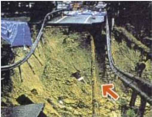
図 7. 震災時の中圧ガス配管 (道路・橋は崩落しても配管は破断していない)
