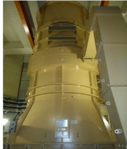
トンネル換気設備（イメージ）
