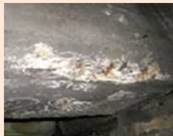
主桁の損傷（鉄筋露出）
