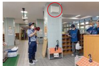
【Wi-Fi設備の確認】
