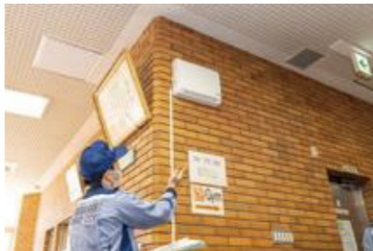
【Wi-Fi 設備の確認】
