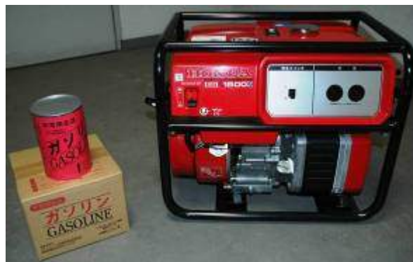
↑ 倉庫に収められている発電機と燃料
