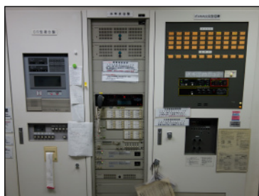
施設内放送設備 (1階防災センター)
