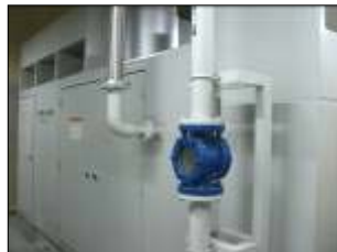
非常用ディーゼル発電機
