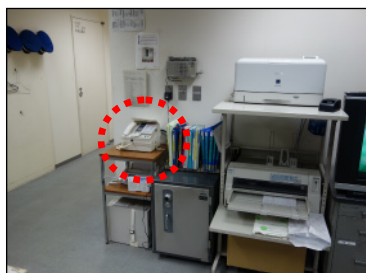
地域防災無線 (1階防災センター)
