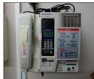
地域防災無線 (1階防災センター) (2階区民館受付)
