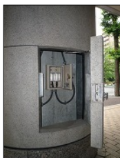
柱内部にあるライフライン設備 (非常用コンセント、水道、ガス)
