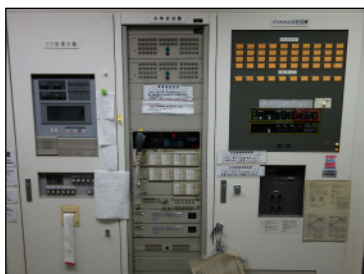
施設内放送設備 (1階防災センター内)
