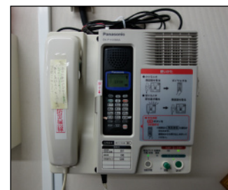
地域防災無線 (1階防災センター) (2階区民館受付)
