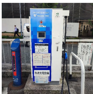
図 3-3 EVスタンド(区役所附属駐車場)
