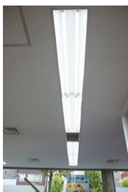
事務所内のLED照明器具
