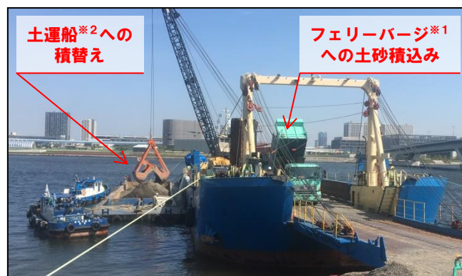
③ フェリーバージ※1への土砂積込み、土運船※2への積替え状況
