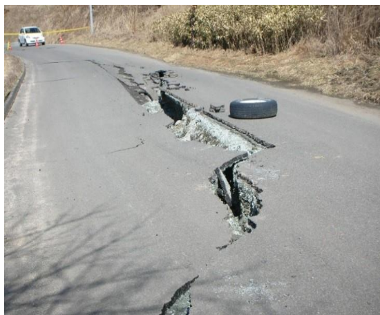
山木屋地区 山木屋田代線 路面陥没、亀裂 (平成23年3月12日)
