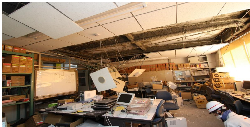
庁舎の天井材崩落 撮影日：平成23年3月12日
