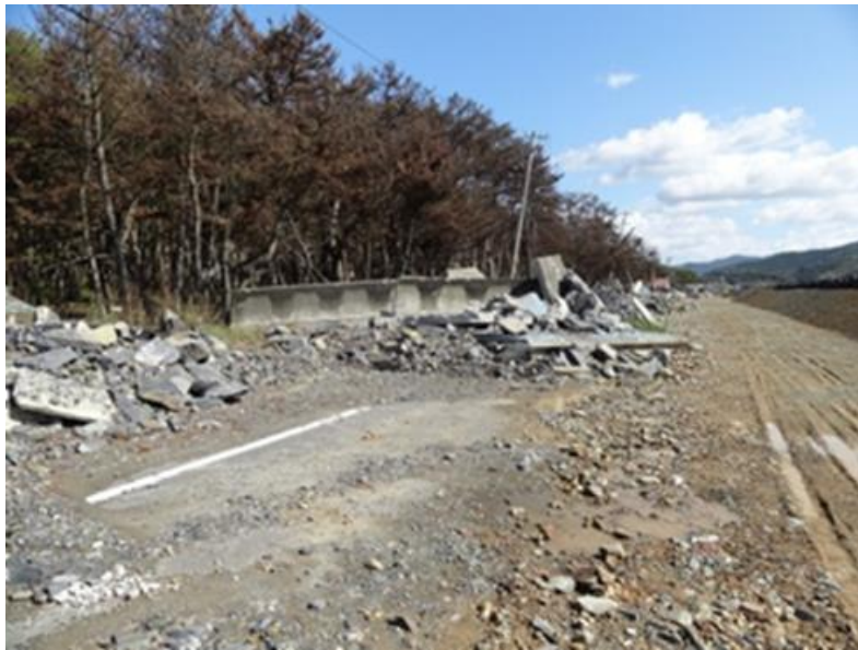
災害後（平成25年2月時点）
