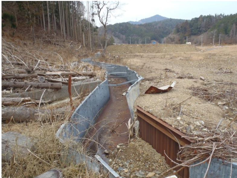
災害後（平成26年12月時点）
